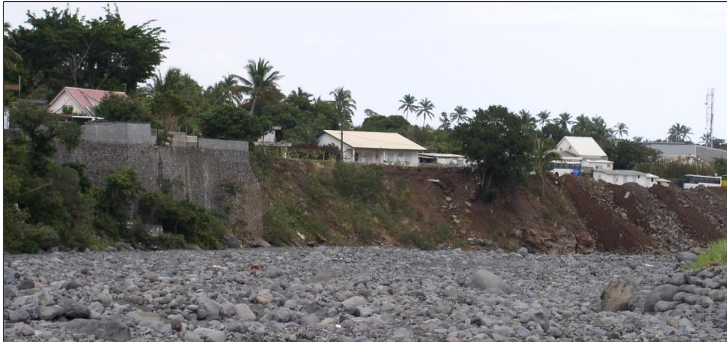
Figure 28 : Berge rive gauche de la Rivière des Pluies - sensibilité variable aux phénomènes érosifs (alluvions consolidées, remblais, berge protégée)
