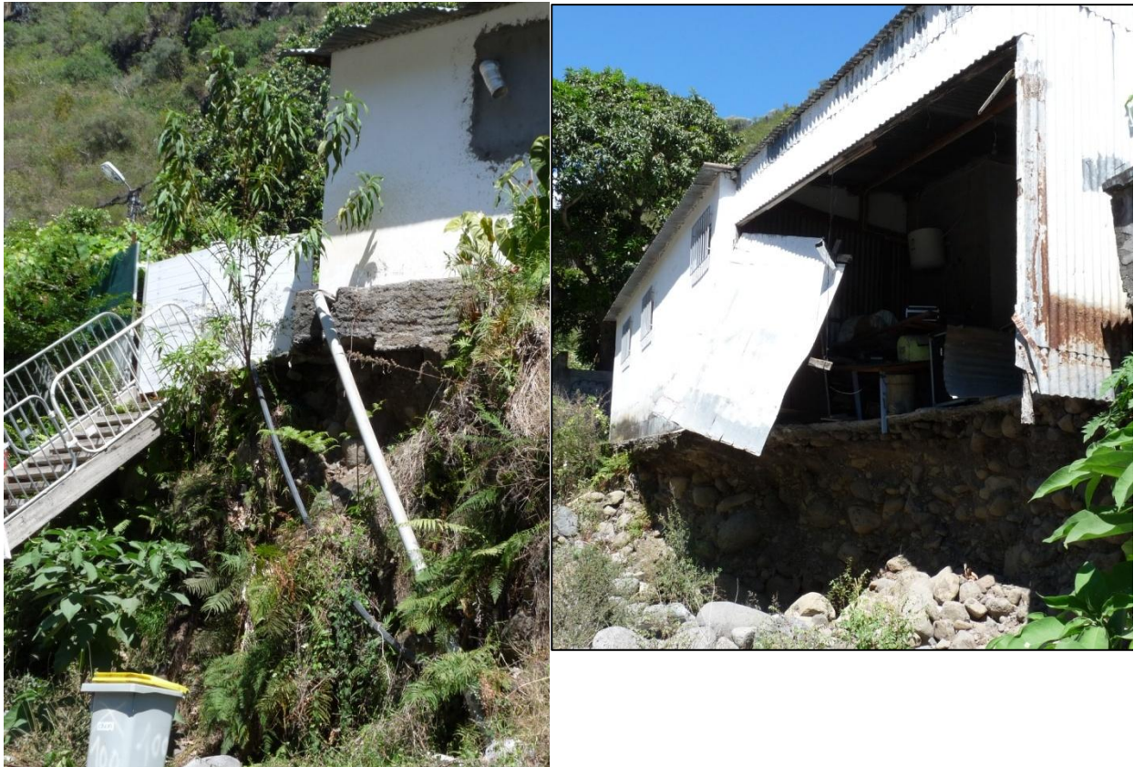
Figure 26 : Constructions affouillées suite au passage de Diwa (mars 2006) - Ilet Quinquinna
