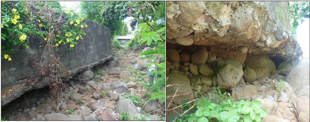
Figure 30 : Ravine Laverdure – affouillement en pied de la digue aménagée le long de la Rue Jules ferry suite au cyclone Hyacinthe
