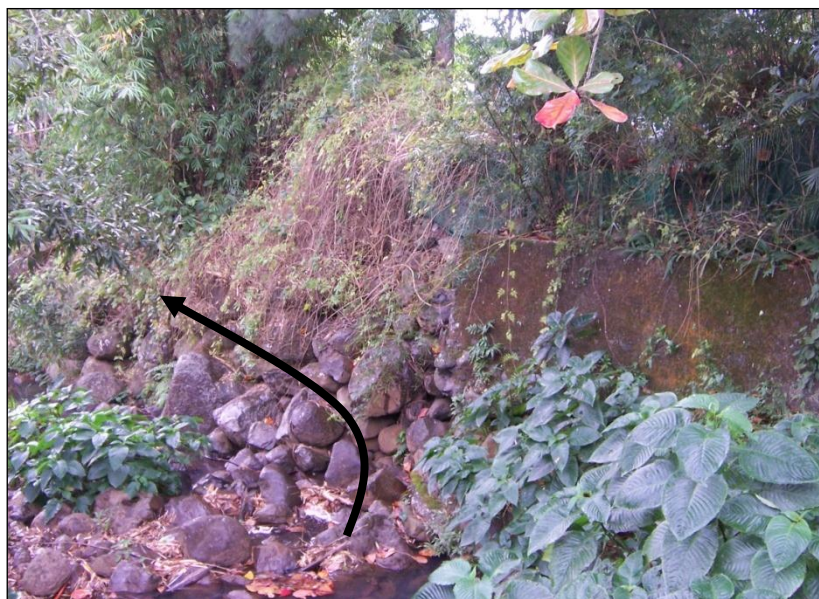
Figure 29 : Berge rive gauche de la Ravine Achard (secteur Ruisseau Blanc) - érosion de berge se développant à l'extrados, en aval immédiat d'un mur béton
