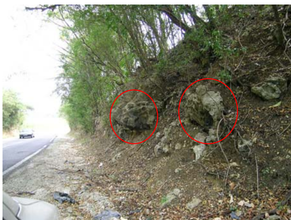
Blocs déchaussés talus routier de la RD116
