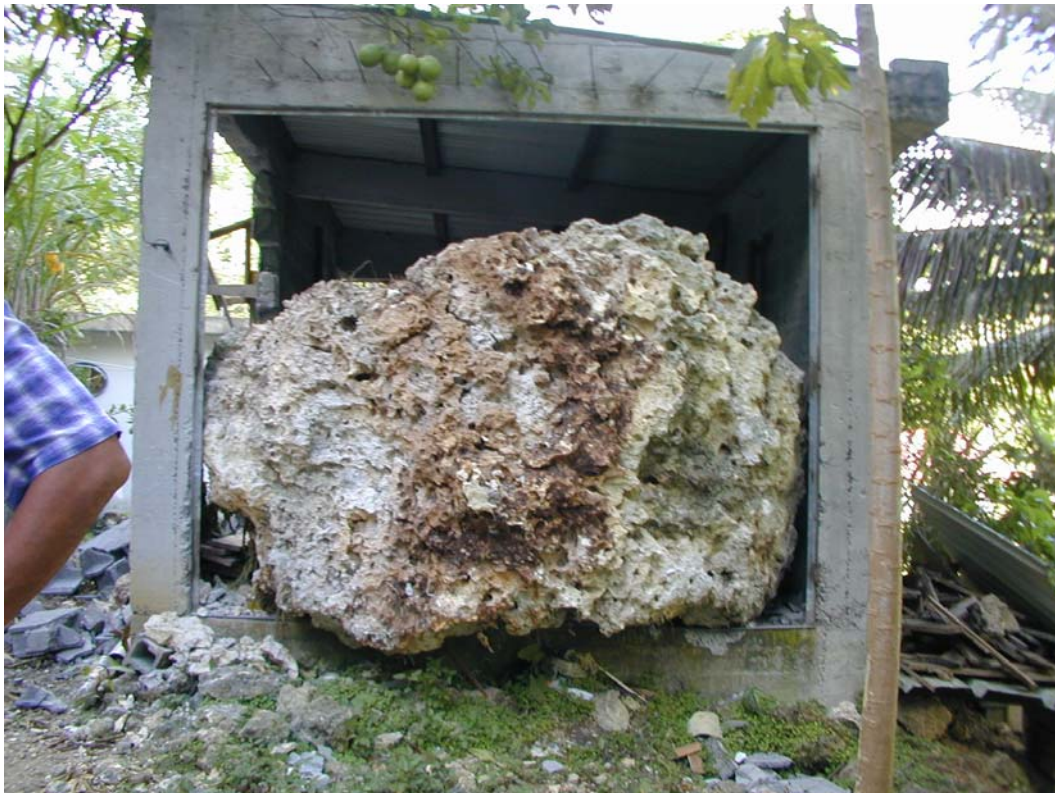
Photo 8 : Exemple de chute de bloc dans le secteur des Grands-Fonds - Abymes, novembre 2000
