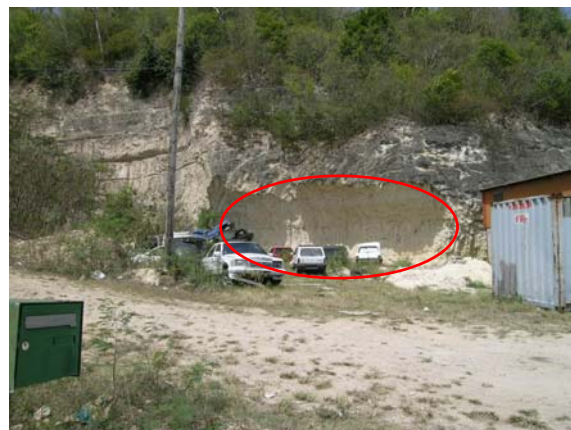
Falaise sous-cavée en pied – RD 102 (secteur de Bragelogne)
