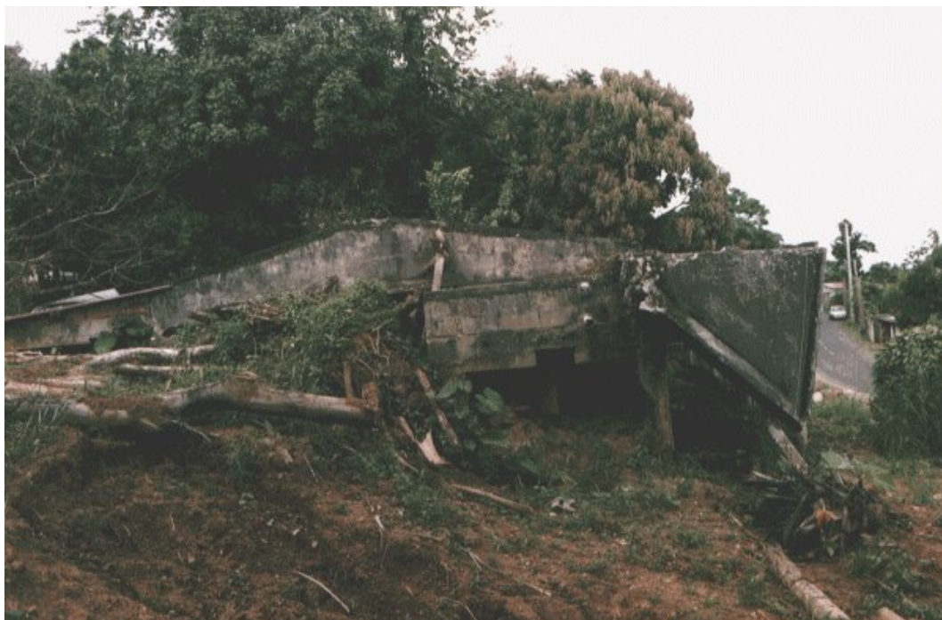
Photo 3 : Maison détruite par un glissement amont
