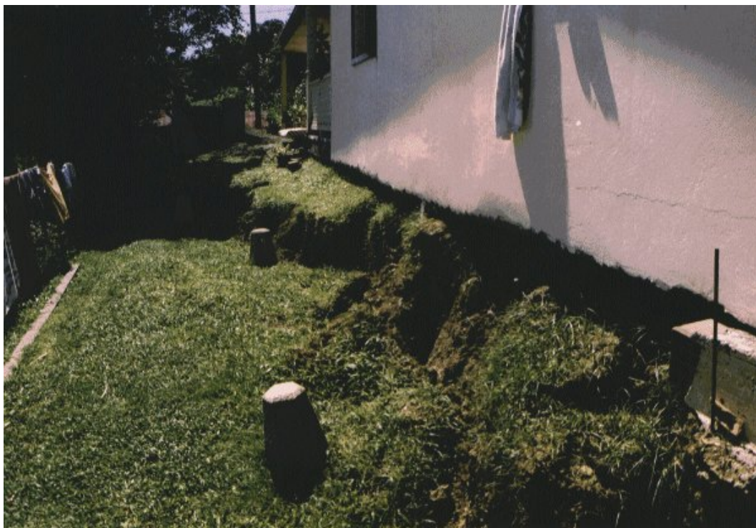
Photo 2 : Glissement des terrains d'assise de la maison (glissement aval)
