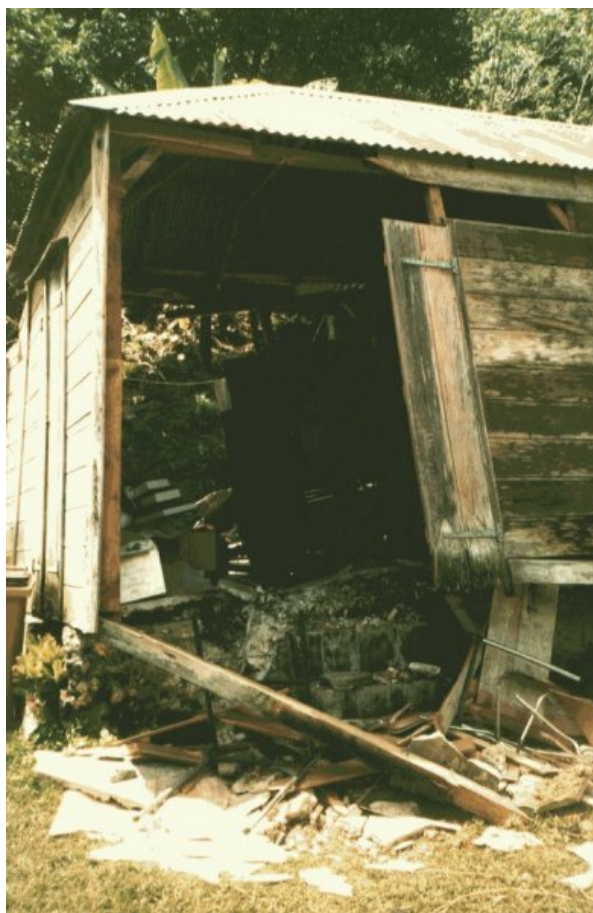
Photo 4 : Exemple de désordre causé par une chute de blocs
