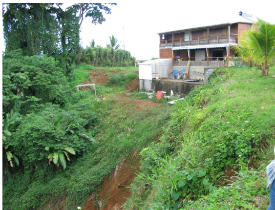
Vue générale sur l'habitation du quartier l'Abandonnée menacée à moyen terme par une glissement de terrain.
