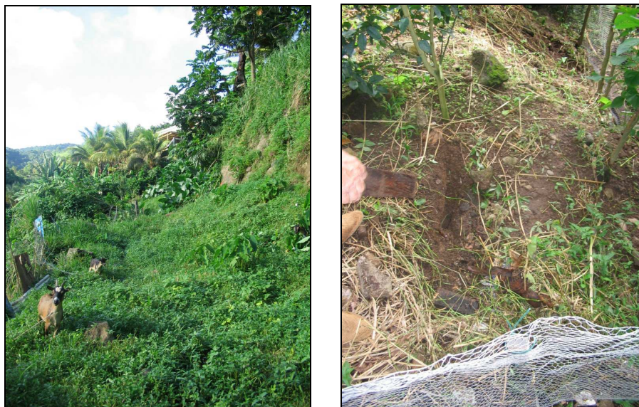
Vue sur le talus artificiel réalisé à l'aval des constructions et sur une fissure résultant de ce décaissement.
