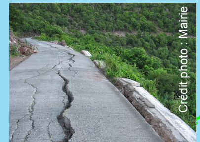
9 : Fissuration de la plate-forme de la chaussée (RD 213)
