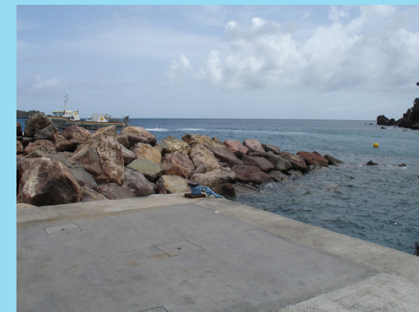
4 : Destruction partielle des digues de l'Anse des Mûriers lors du passage de Dean
