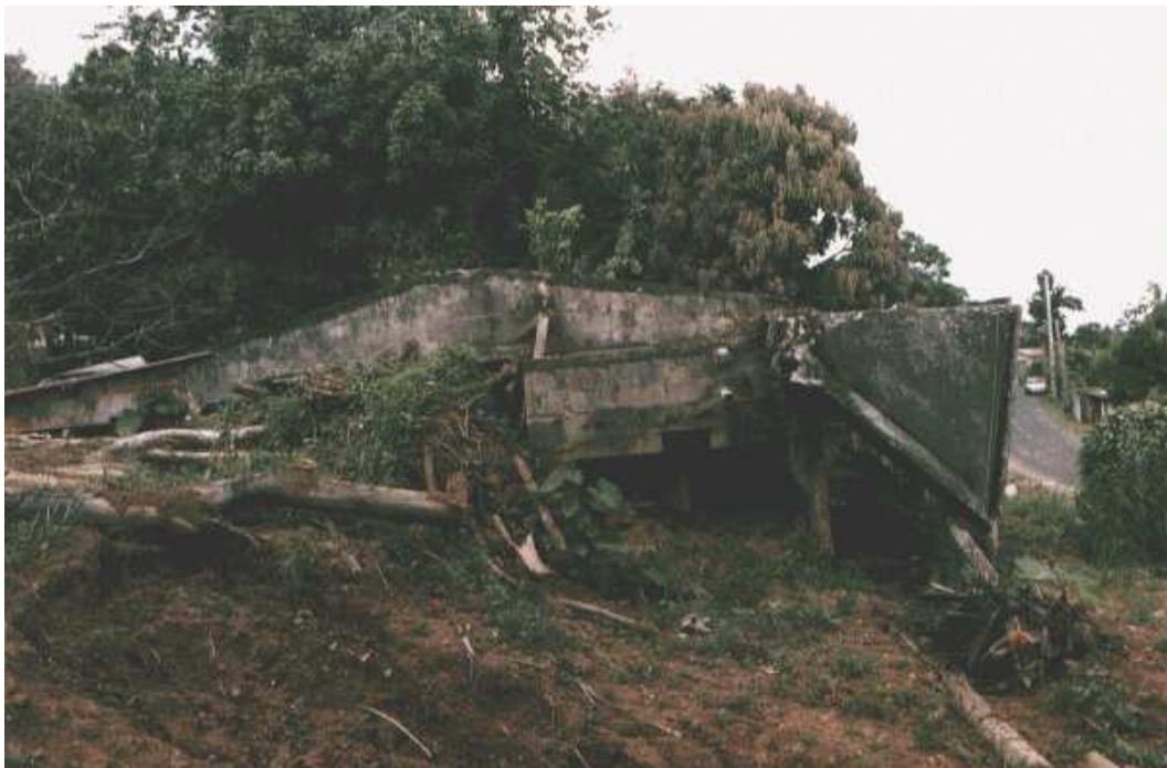
Photo 3 : Maison détruite par un glissement amont
