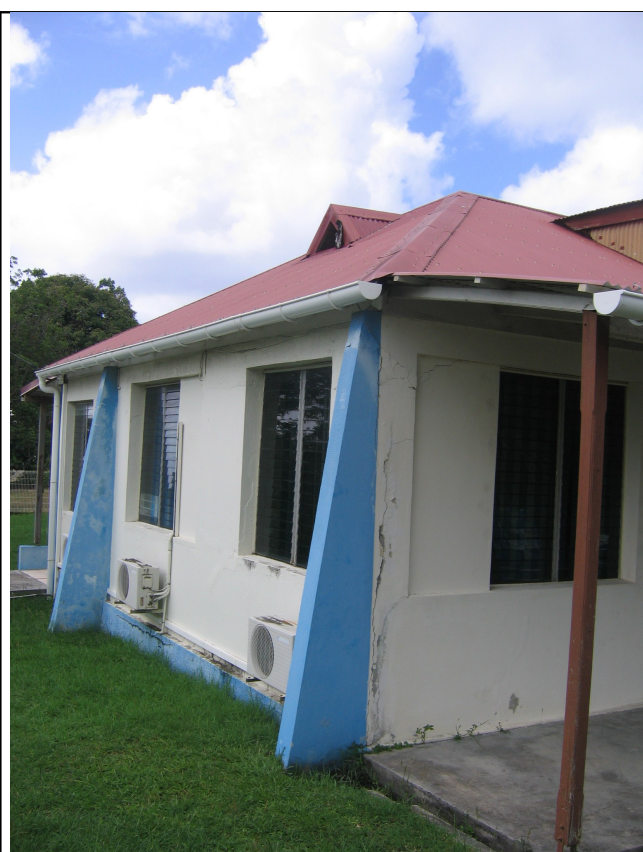
Photo. 7 : Fissuration à l'angle du bâtiment de la DEAL (Ex-DDE).
