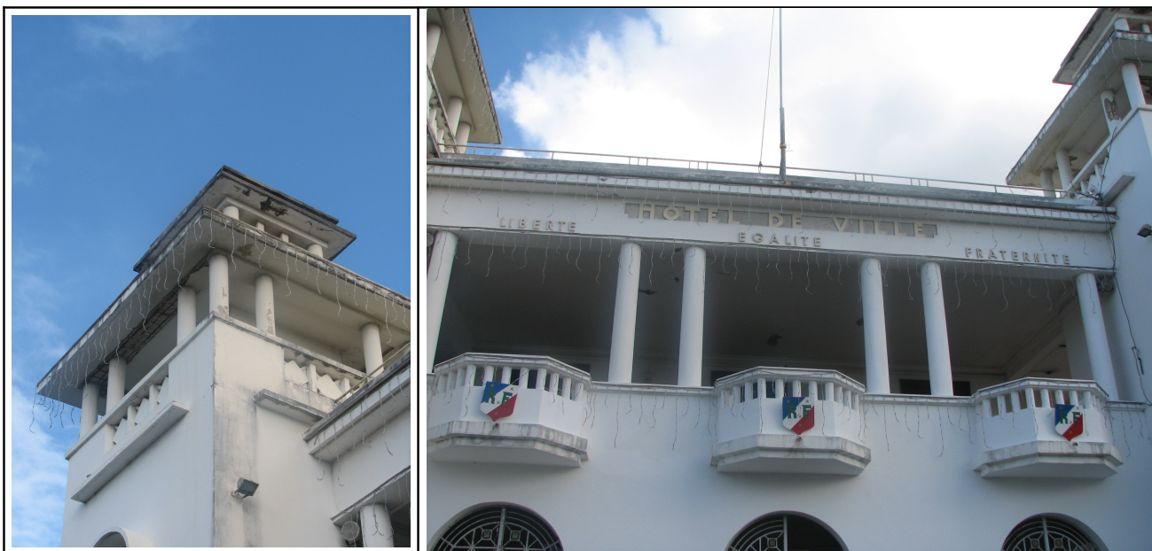
Photo. 5 : Eclats de bétons visibles sur la mairie de Grand-Bourg.
