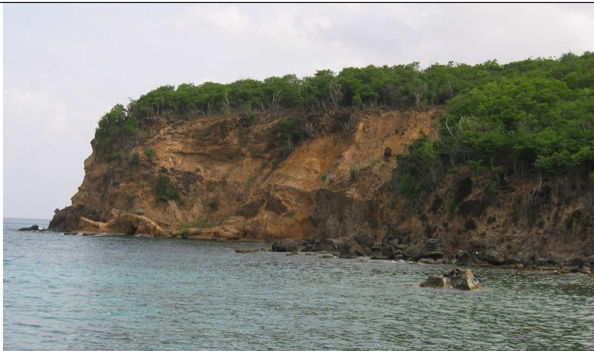
Photo. 1 : Eboulement de la falaise de l'Anse Beaugendre, au Sud de Baille-Argent.
