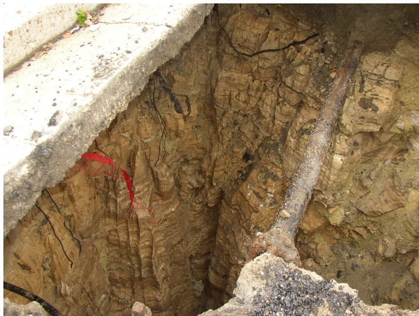
Figure n°16: Exemple d'effondrement de chaussée suite à des fuites du réseau d'assainissement – Commune de Villetaneuse, butte de Montmorency (photographie source CETE IF)
