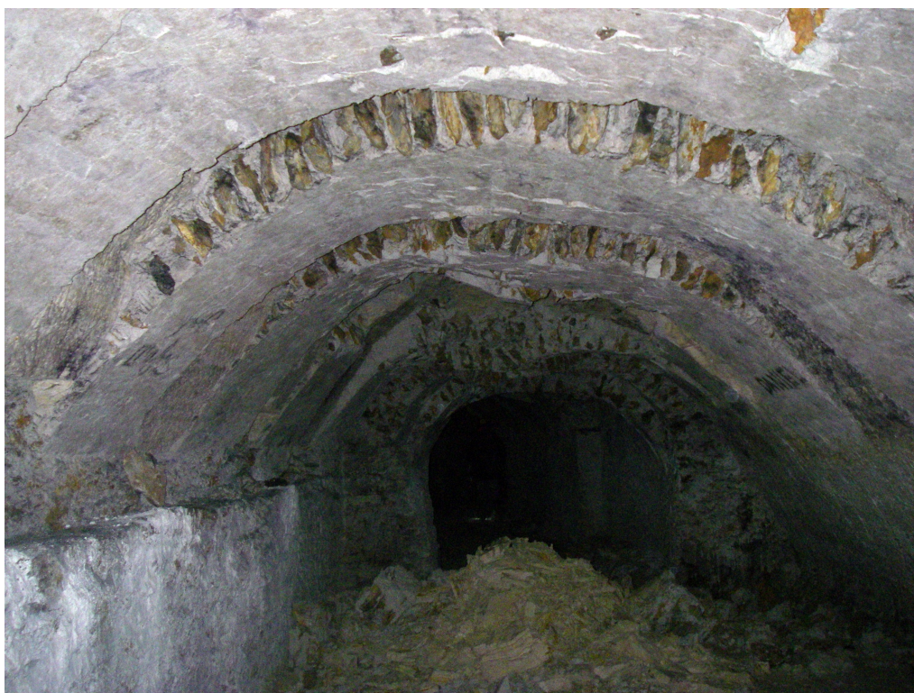
Figure n°22 : Exemple de galerie dégradée dans le gypse consolidée par de petites voûtes par l'exploitant (IGC-Evecquemont)
