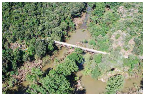
Photos 53 : Pont sur l'Aille à la confluence avec l'Argens - vue post crue
