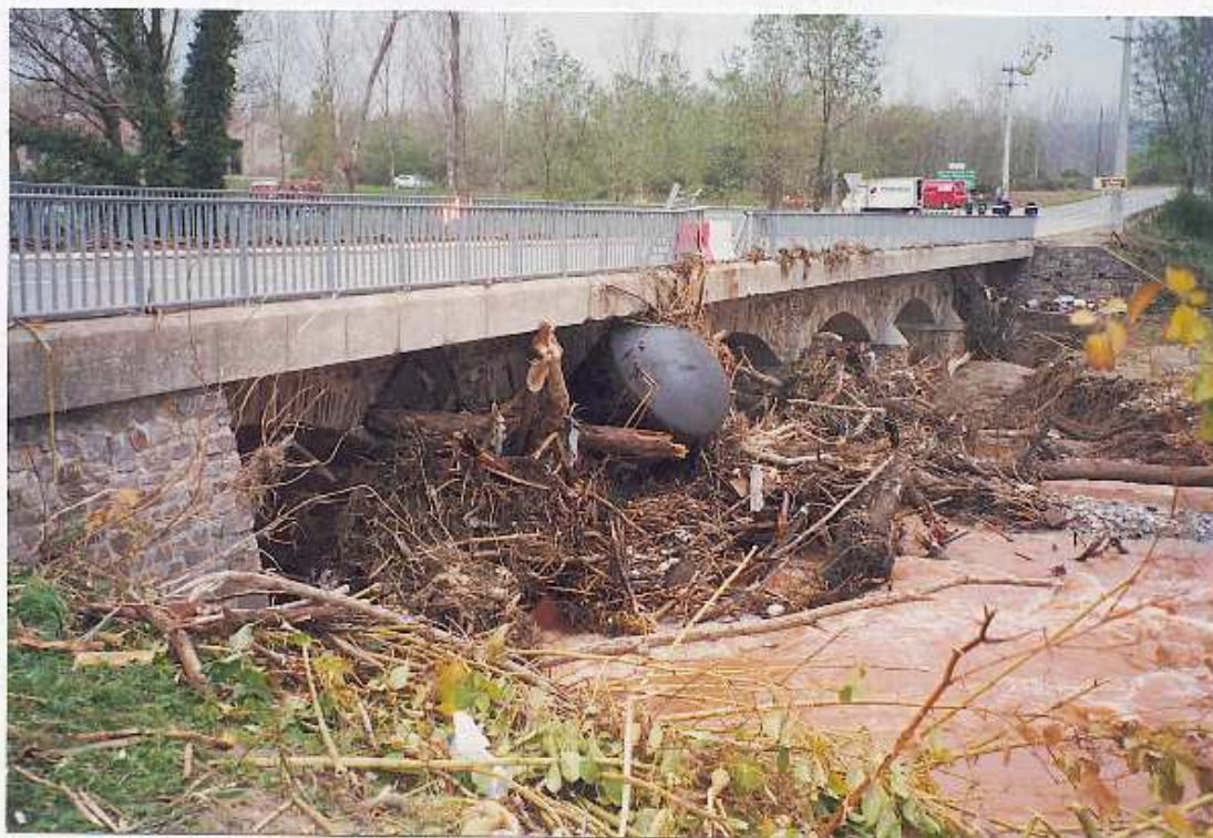
Embâcle au pont aval de la Richarde, sur le Thoré (crue de 1999) photo DDE81
