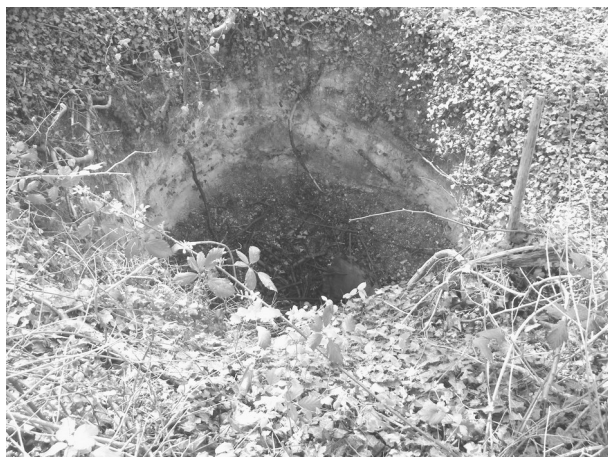
photo 6: Fontis en bordure du chemin du bas du parc
