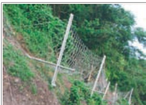
ou filets pare-blocs
