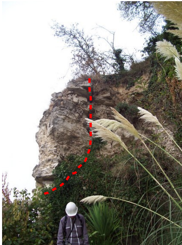
Figure 30 : Masse prédécoupée et instable dans les Marnes et Caillasses (source: CETE Ile de France)
