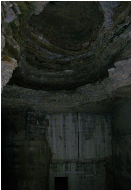
Photo 12 : Exemple d'une cloche de fontis situé dans une des carrières de Conflans. Les parpaings visibles constituent un des murs barrages servant aux travaux de consolidations de l'avenue de Bellevue.
