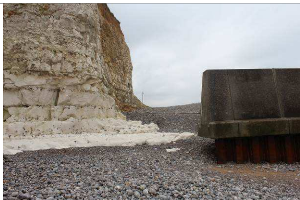
Epis 1 : déchaussement par contournement de l'épi
