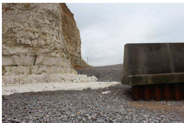
Epis 1 : déchaussement par contournement de l'épi
