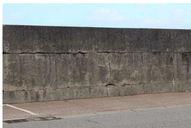
Fisures et déchaussements de blocs béton au niveau du parement de la promenade
