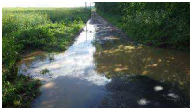
Photographie 9 - Inondation par traversée d'écoulement d'un talweg situé perpendiculairement à une voirie
