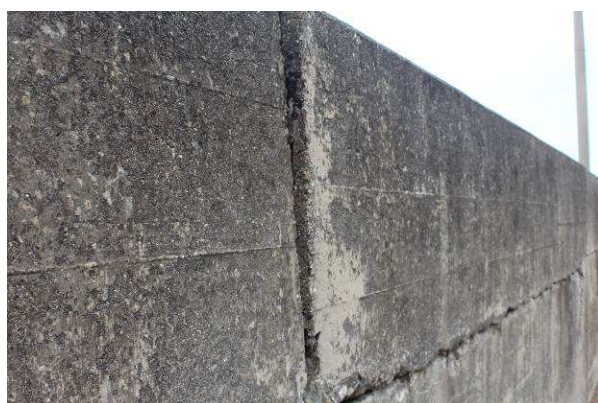
Déchaussements de blocs béton au niveau du parement de la promenade
