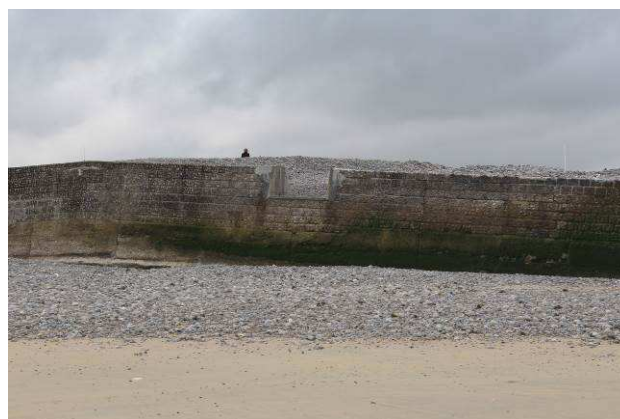
Fort engraissement à l'Ouest de l'Epis ayant nécessité la mise en place d'un déversoir pour galets
