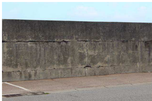
Fissures et déchaussements de blocs béton au niveau du parement de la promenade
