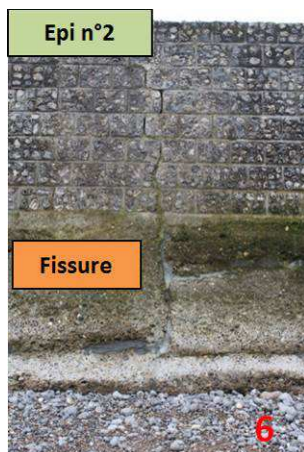
Fissure et déjointoyage (Epis 2)
