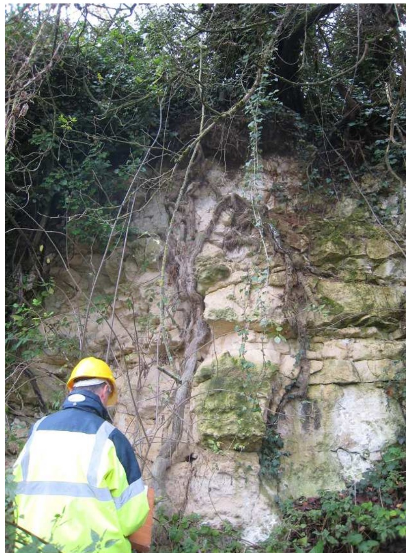
Figure 25 : dégradation du coteau par l'action de racines
