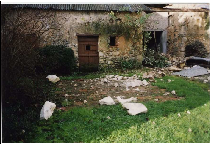
Figure 10 : Chutes de pierres et de blocs - Parcé-sur-Sarthe
