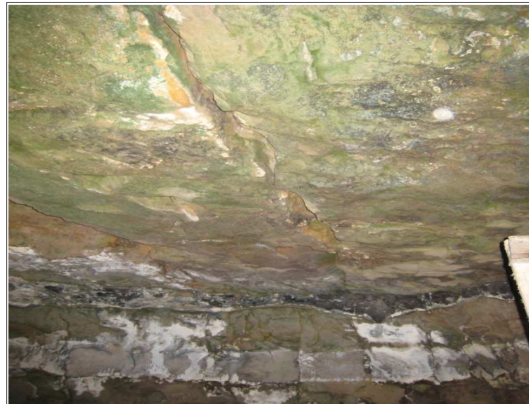
Figure 5 : Fractures de décompression d'ouverture centimétrique dans une cave – Parcé-sur-Sarthe
