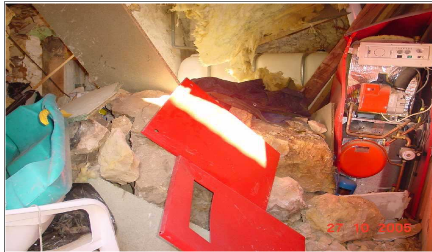
Figure 21 : Intérieur de la cave effondrée
