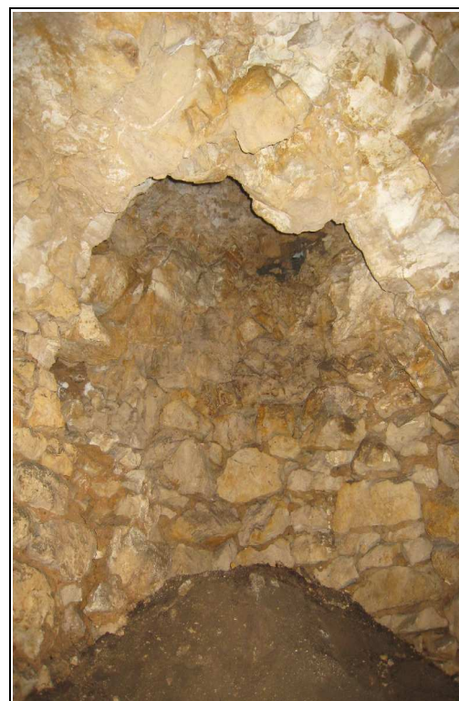
Figure 22 : Fontis : illustration d'un cône d'éboulis dans une cave à Parcé-sur-Sarthe
