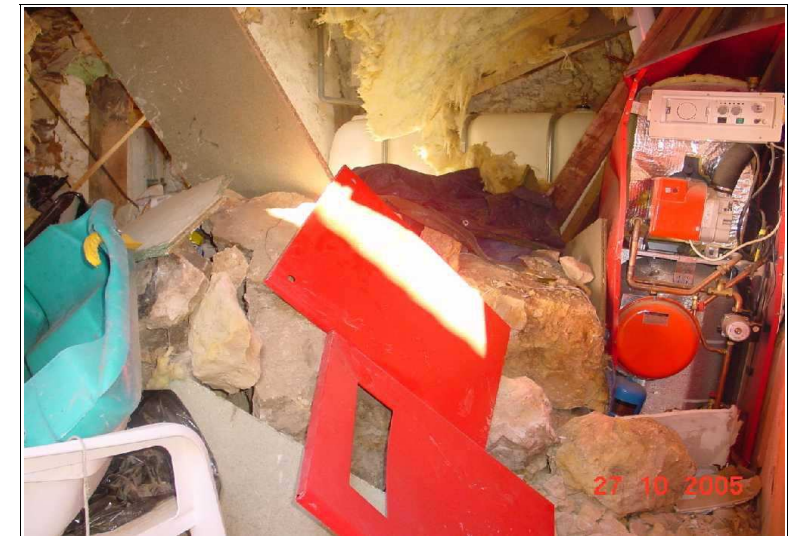
Figure 31 : Intérieur de la cave effondrée
