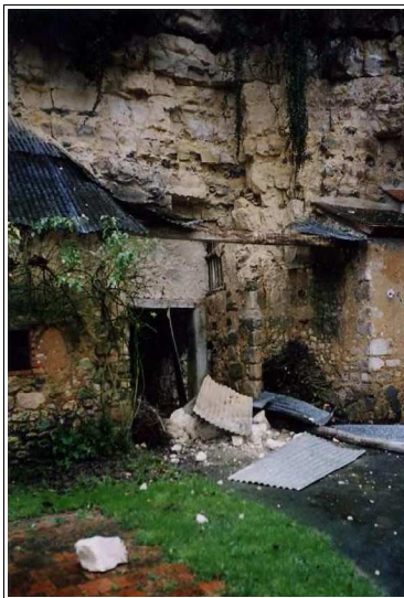
Figure 36 : Éboulement, chute de blocs, événement janvier 2003, la motte féodale
