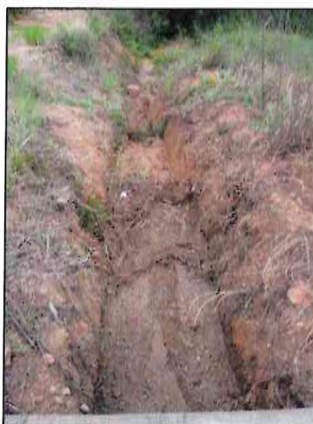
Ravine aménagée comblée de matériaux fins
