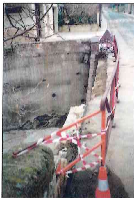
Ravin de Cassenove ou Millère amont. Après le passage de la crue de 1999 : rambarde arrachée par la crue débordante reconstruite rapidement après l'événement.
