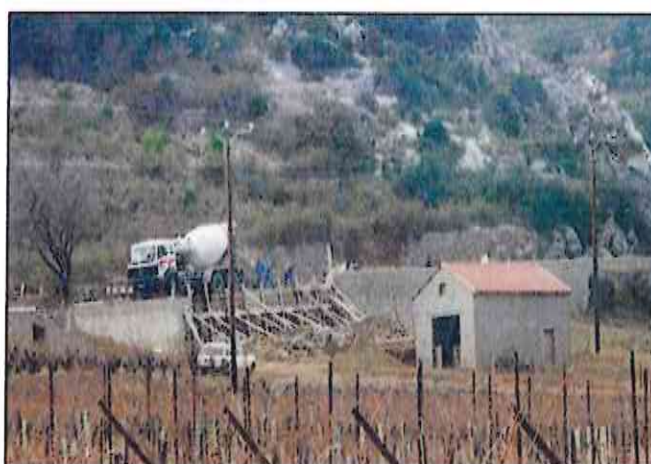
Mouvement de terrain sur le soutènement de la RD12 en direction de Tuchan à la suite de l'événement pluvieux de 1999 : Travaux de reprises du soutènement et drainage
