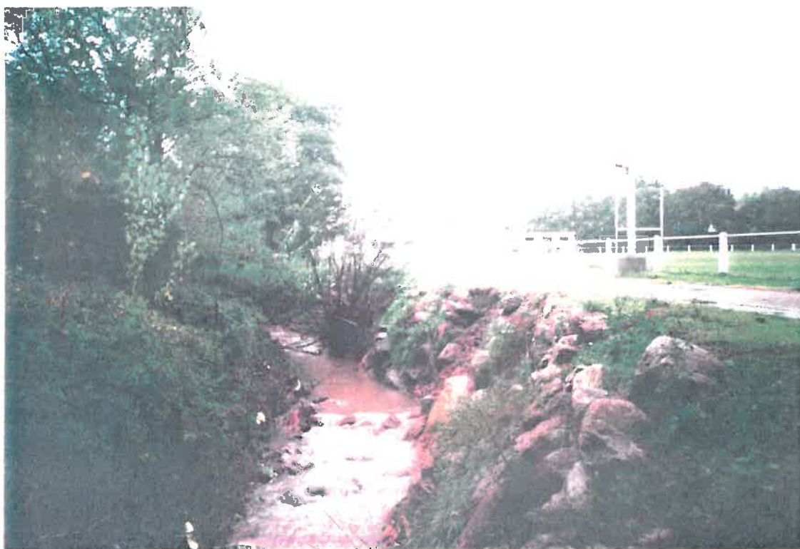
02. Le ravin de Las Blanques près du stade municipal le lendemain de la crue. Par endroit les berges se sont affaissées et au plus fort de l'orage le ravin menaçait de déborder près de l'entrée du stade.
