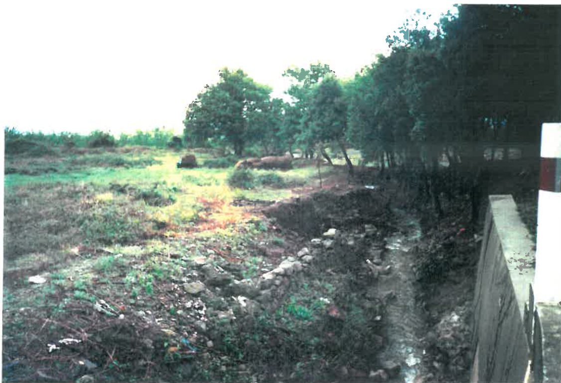
05. Le ravin Saint Laurent de Galici en aval de l'Avenue des Mas Catalans. A ce niveau, la crue a déposé des graviers sur la route et sérieusement endommagé les berges du ravin.
