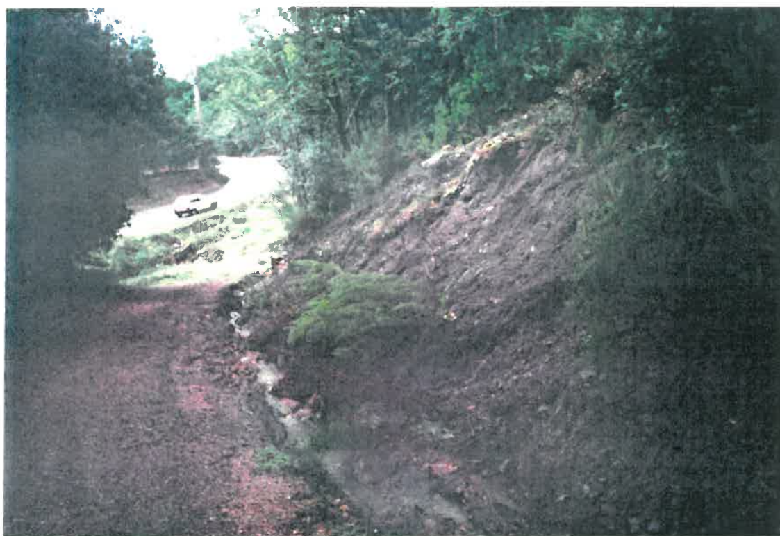
06. Route du domaine des Albères. Plusieurs petits glissements ont affecté les différents talus de la commune (ici, poche de schistes noir).
