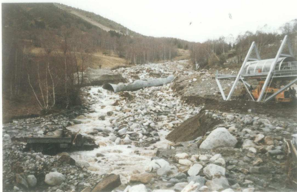
(Ph. 8. DDE Saillagouse). La buse est affouillée, contournée et écrasée. Le télésiège de la station est menacé. Le parking emporté.
