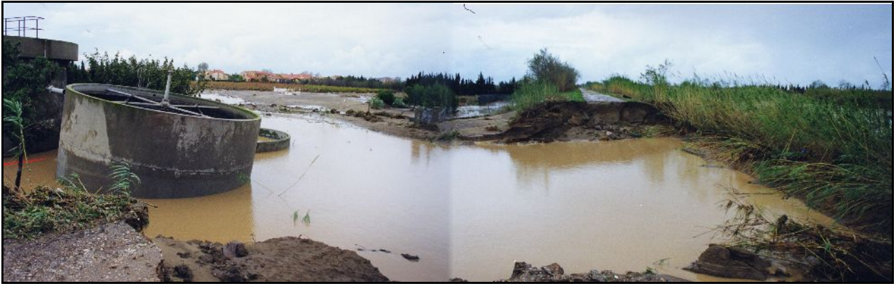
Panoramique de la brèche de Saint-Laurent après la crue de novembre 1999
