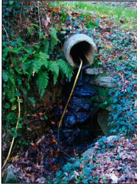
Figure 32: Rejet d'eau dans le versant dans le secteur du Barrat [Source : IMS AV ]
