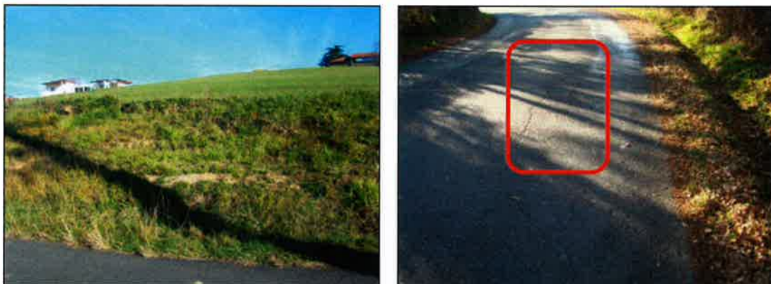
Figure 28 : Glissement de talus (à gauche) et fissuration de la chaussée (à droite) [Source : IMS RN ]
