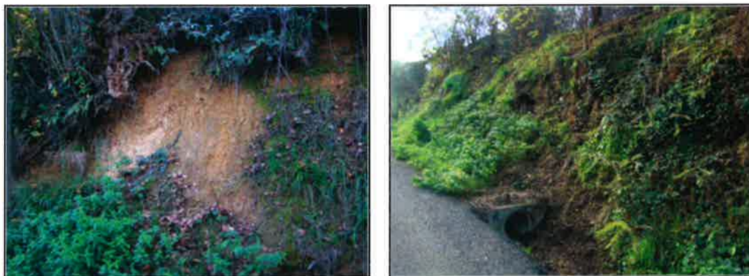
Figure 34: Talus déstabilisé (à gauche) et talus instable avec fossé non bétonné en pied (à droite) [Source : IMS RN ]
