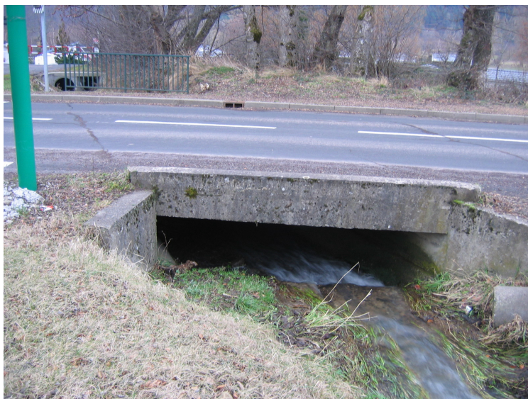
Photo 9 : ouvrage sous-dimensionné au lieu dit Varennes (en relation avec une sursédimentation (point 2) (photo BCEOM)
