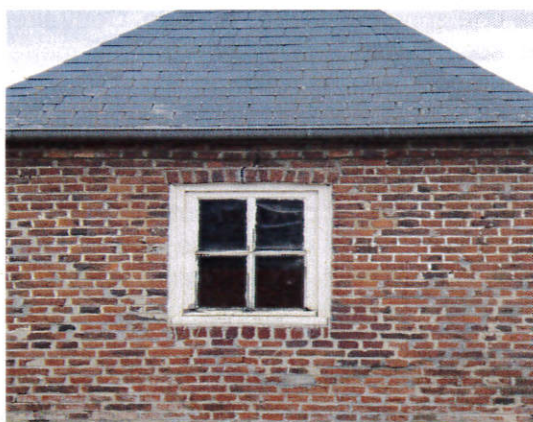
Sinistres observés sur des bâtiments à BUSSY (source : photos réalisées par la DDT)
