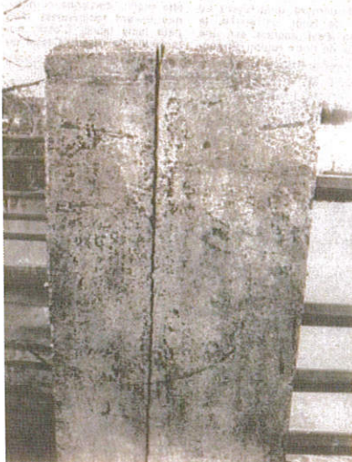
Fissure au pont Saint-Pierre.
