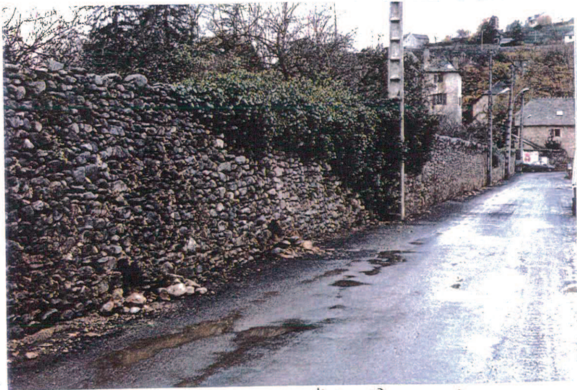
Quartier des "Le Roues" Mur de Framond - trous réalisés pour évacuation.
