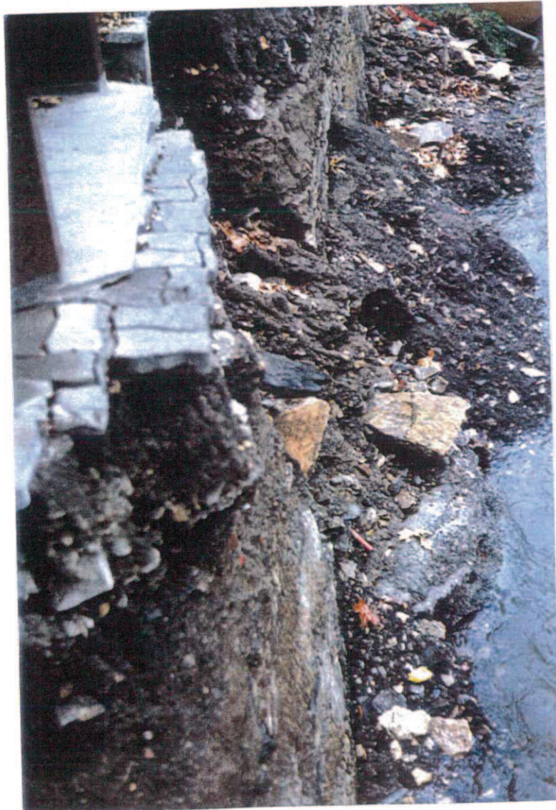
Salle Polyvalente - Dégâts.
