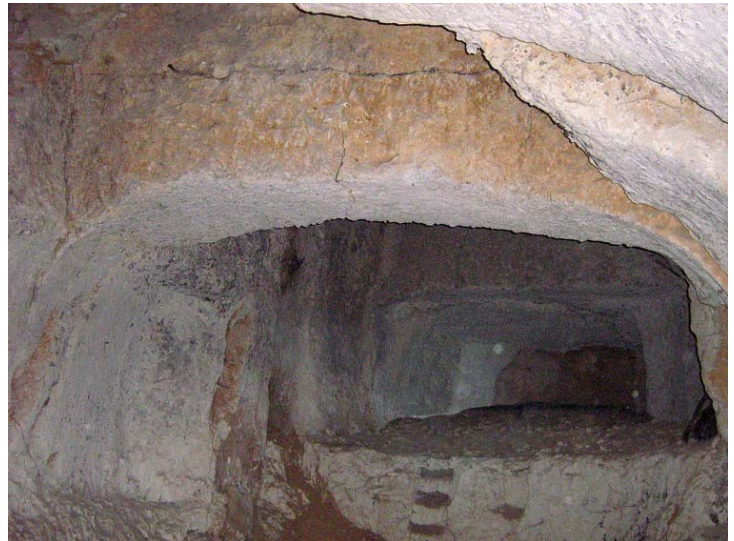
fracturation de voûte
