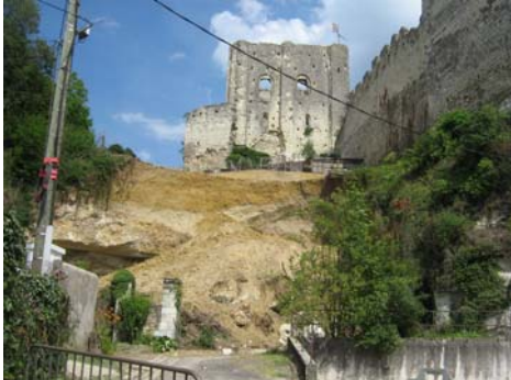
Effondrement en masse du coteau au pied du donjon de Montrichard (juin 2010)
