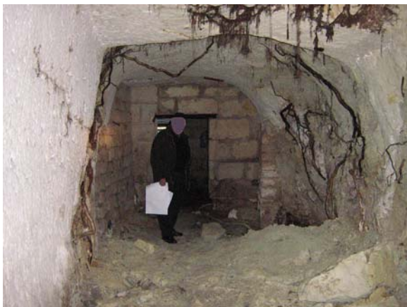
Chute ponctuelle du toit d'une cavité sous l'action des racines
