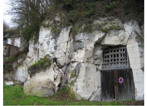
Illustration du phénomène d'appel au vide (fracture verticale et parallèle au coteau) – Bourré février 2008
