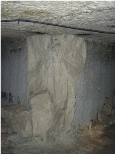
Les piliers de cette champignonnière sont soumis à une trop forte charge
