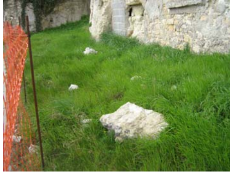
Chute de quelques blocs au pied du coteau à Montrichard (avril 2009)
