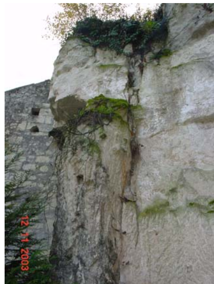
Les racines dégradent également le coteau provoquant des chutes de pierres
