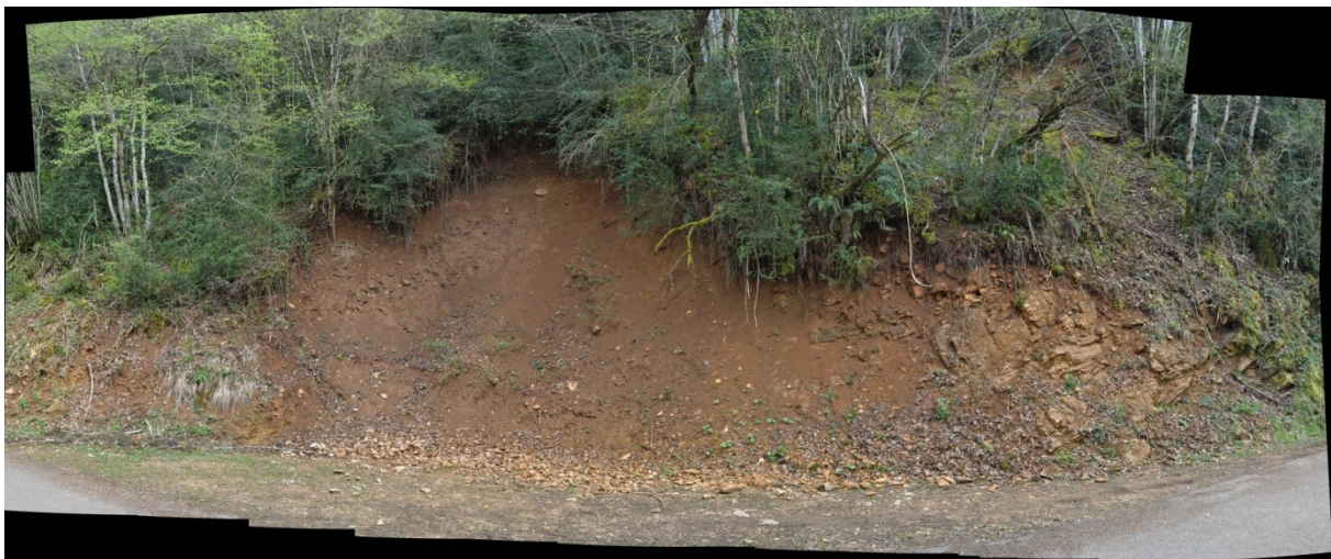
Figure 11: Talus amont de la route de Villette à Turgon
