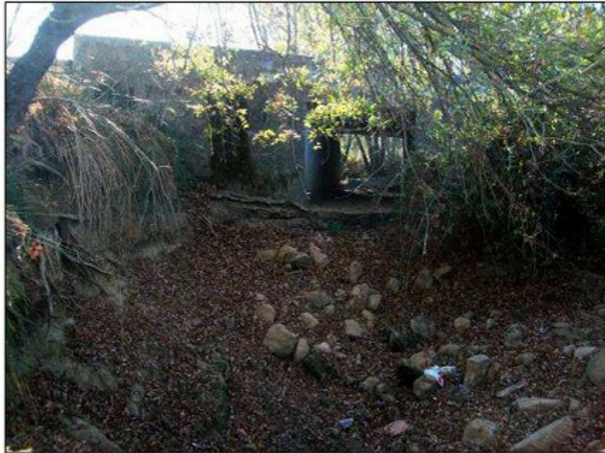
Désordres sur ouvrage : la Rière en aval de la Pinède
