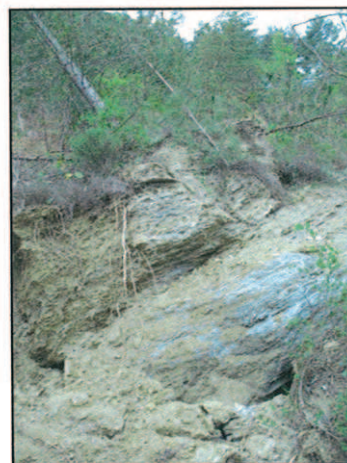
Photo : Glissement aval de l'Usclade, présence de masses stratifiées dans le glissement issues du substratum.
