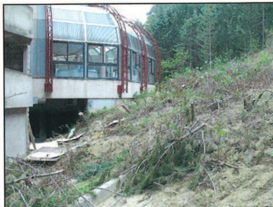
Photo : Glissement aval de l'Usclade, front de glissement butant contre le pavillon Leroy.
