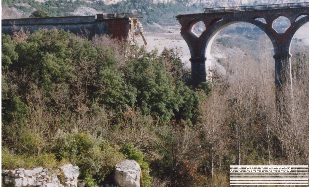
Figure 27 : Le viaduc de Pégaïrolles a été construit sur le bourrelet de pied d'un glissement de versant à mouvement lent, seulement visible au travers des dégâts que subissait régulièrement le viaduc (depuis 1860). Ouvrage ruiné et détruit en 1999.
