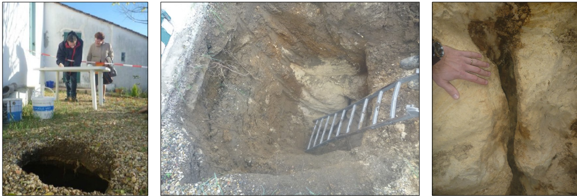
Fig. 14 : Apparition d'un fontis à Latresne [Gironde] lié au déboufrage d'une fissure karstique (visible au fond derrière l'échelle) ayant entraîné les terrains superficiels [Source : Bureau des Carrières de Gironde]
