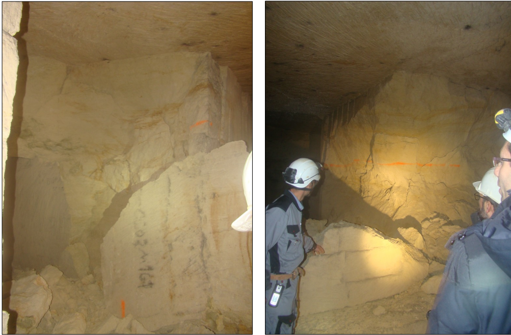
Fig. 38 : Rupture d'angles de piliers dans la carrière du Château (Niveau -3) [Source : Ginger CEBTP]
