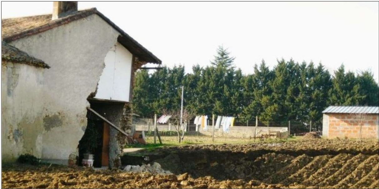
Fig. 77 : Effondrement du 08 février 2011 à SAINT-GERMAIN-DU-PUCH (Gironde) [Source : Sud-Ouest]
