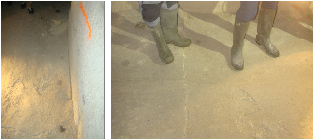
Fig. 40 : Fissuration des remblais, en pied de pilier (à gauche) et entre 2 piliers (à droite), dans la carrière du Château (Niveau -3) [Source : Ginger CEBTP]
