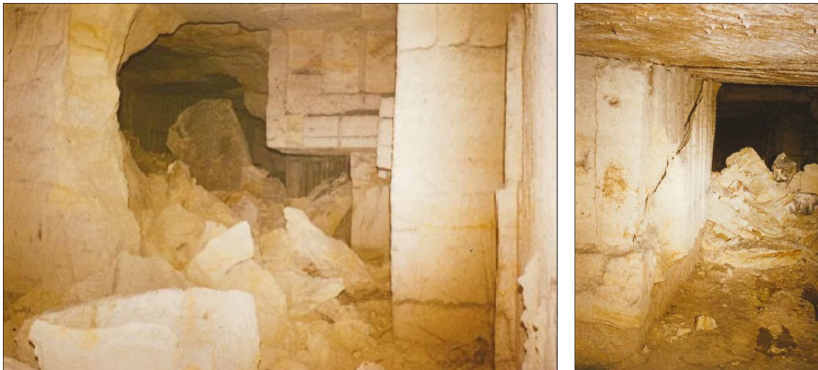
Fig. 21 : Effondrements du ciel de carrière et fissuration d'un pilier [Source : BRGM]
