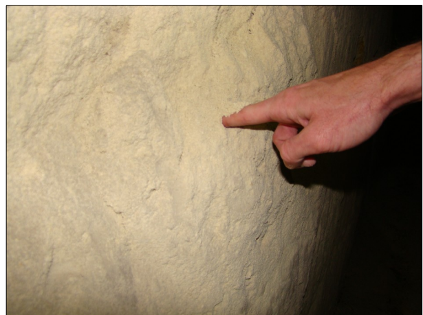
Fig. 41 : Perte de cohésion des calcaires sur la surface d'un pilier dans la carrière de Brun (Niveau -3) [Source : Ginger CEBTP]
