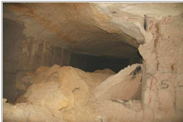
Effondrement de la carrière ayant conduit aux fissurations constatées dans le quartier de Gazeau en 2008 (phénomène J7). L'édifice présente un état quasiment de ruine. Une poursuite de son effondrement avec de nouveaux impacts en surface est hautement probable.
