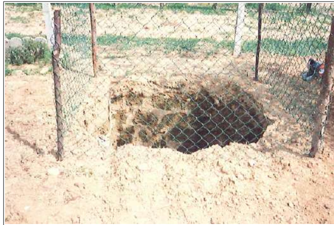
Formation d'un fontis sur la parcelle C3 (lieu-dit La Borie-Dagen). Le phénomène s'est produit sur l'emplacement d'un puits remblayé (une paroi du puits est visible sur la photo). Il est dû à l'affaissement des matériaux de comblement.
