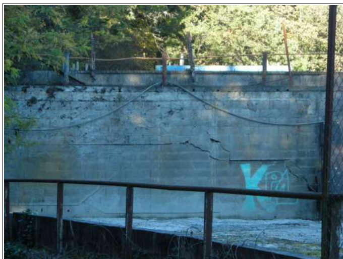
Usine KP1 au niveau d'une plate-forme de stockage et de manutention, on notera la fissuration avancée du mur, caractéristique d'un affaissement du sol.
