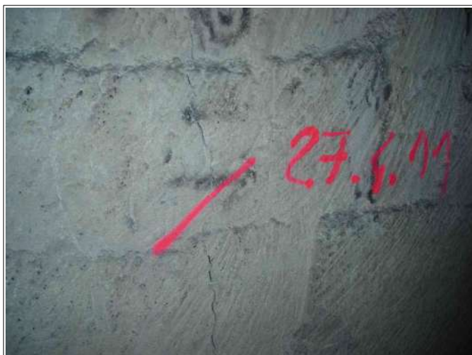
Fissuration mécanique d'un pilier non loin de l'effondrement de Saint-Germain-du-Puch (lieu-dit la Manière). La carrière est très dégradée sur quelques milliers de mètres carrés. Ce secteur est surveillé par le Conseil Général.
