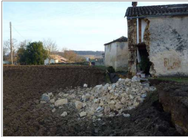
Effondrement au lieu-dit La Manière en février 2011. Le bâti a fortement souffert, comme en témoigne le mur éboulé de la maison. On notera également le décrochement de terrain d'environ 1,5 mètres et la forme en cuvette du terrain.
