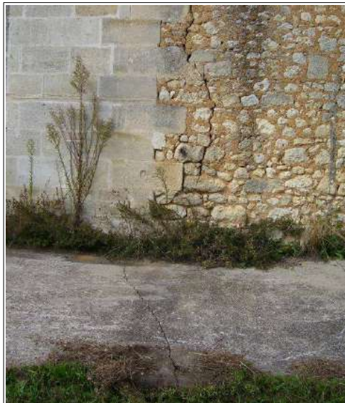
Bâti et voirie fissurés au lieu-dit Gazeau (2008), suite à des mouvements de terrain au niveau d'une carrière souterraine.
