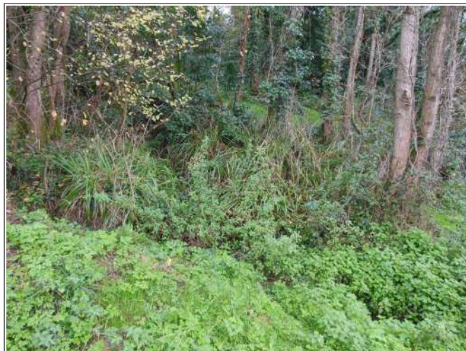
Gros plan sur les talus de la voie communale reliant le village au lieu-dit Jalet, on remarquera le caractère humide du terrain, favorable aux mouvements de terrain.
