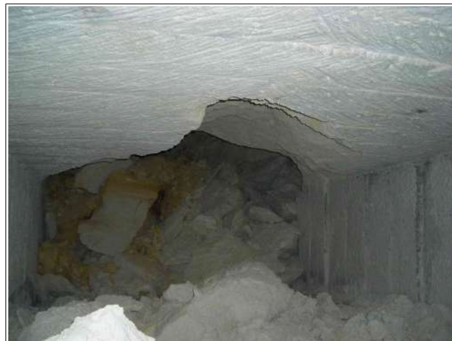
Effondrement du lieu-dit La Manière en février 2011, vue souterraine du phénomène. Le chaos visible en arrière plan témoigne de l'effondrement total de la carrière.
