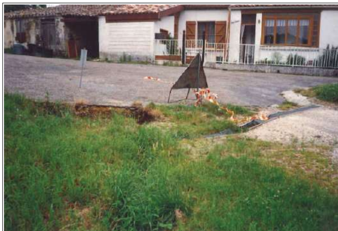
Fontis de 1990 et 1993 au niveau de la voie communale 11, la carrière en cause est décrite comme dangereuse.
