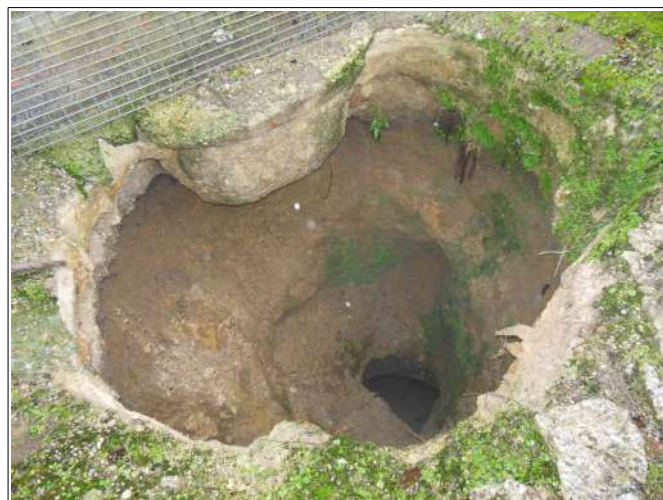
Fontis au droit d'un hangar de l'entreprise de maçonnerie Neveu (lieu-dit Garigau), on distingue au fond une ouverture en direction de la carrière sous-cavant ce secteur. On notera également la fondation suspendue du bâtiment (bloc de béton en haut de la photo).
