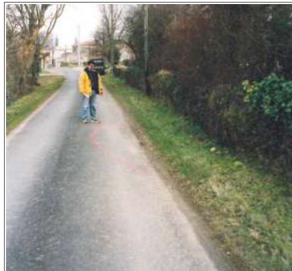
Affaissement de la voie communale n° 4 (marque rouge au sol). Cette voirie est aménagée au dessus d'une cavité déjà frappée par des mouvements de terrain souterrains.
