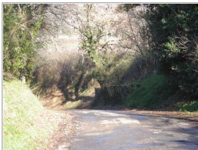
Hameau de Lagu, les talus de la VC6 glissent régulièrement sur la chaussée.
