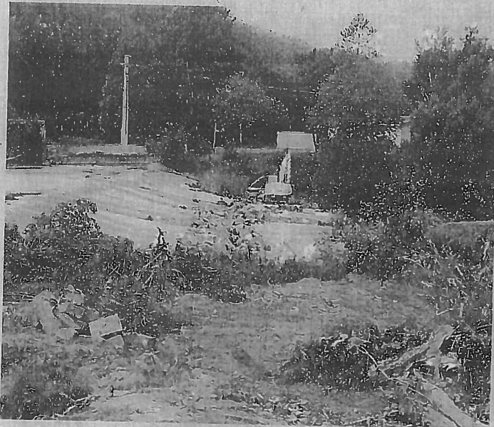
La restauration de la digue au pont vient de débuter sous la maîtrise d'ouvrage de l'Institution Adour. / Photo DDM, J. G.
