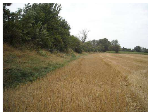
Aperçu de la digue en rive droite de l'Hers, à l'aval immédiat de la bretelle de l'A65
