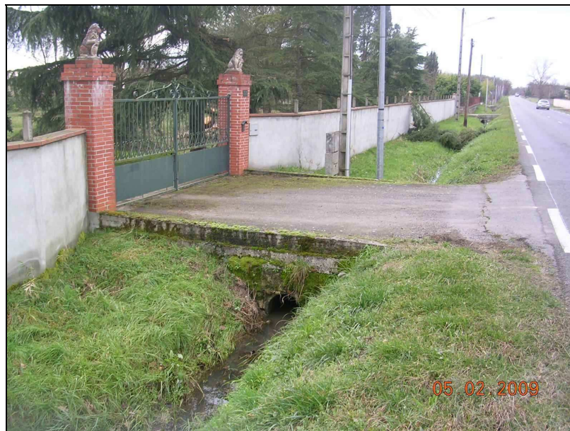
Photo n° 1 : Commune de Seysses, RD 12 au lieu-dit Largenté. Lors de la crue l'eau est arrivée au niveau de la route qui était coupée plus loin. Il y avait entre 0.40 et 0.50 m d'eau dans le jardin.
