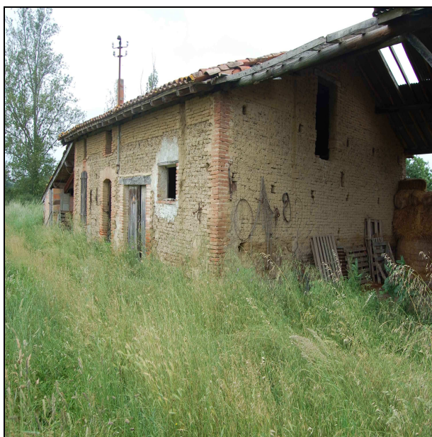
Photo n° 1 : Commune de Lamasquère, grange au lieu dit Fougrouse. Lors de la crue de février 1952, il y avait entre 0.60 et 0.70 m d'eau dans la grange (180,72 m NGF).
