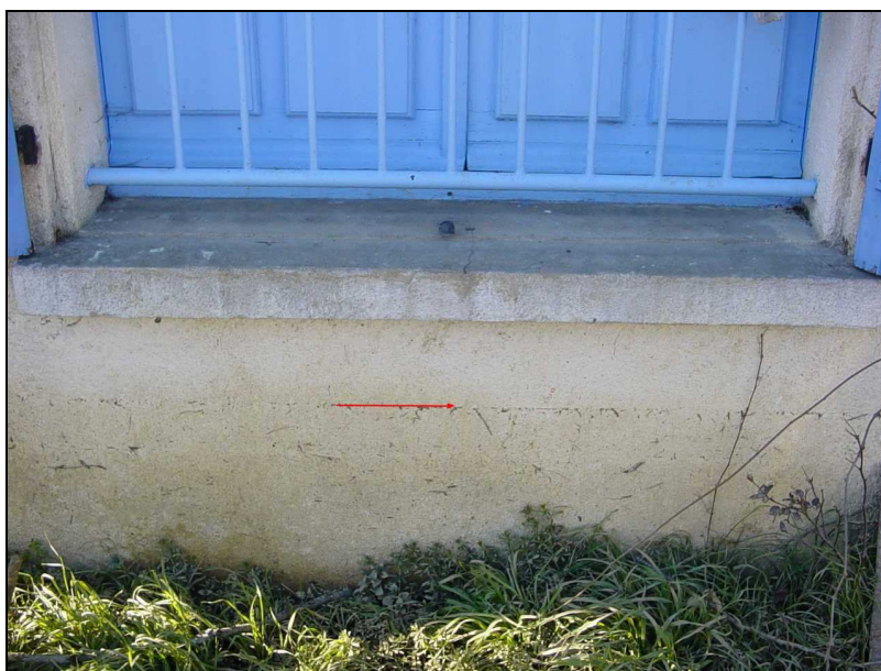
Photo n° 1 : Commune de Fonsorbes, lieu-dit Moulias en amont de la RD 68. Lors de la crue du 4 février 2003, l'école d'équitation a été inondée. Sur la photographie on aperçoit une laisse de crue (0,48 m par rapport au terrain naturel).
