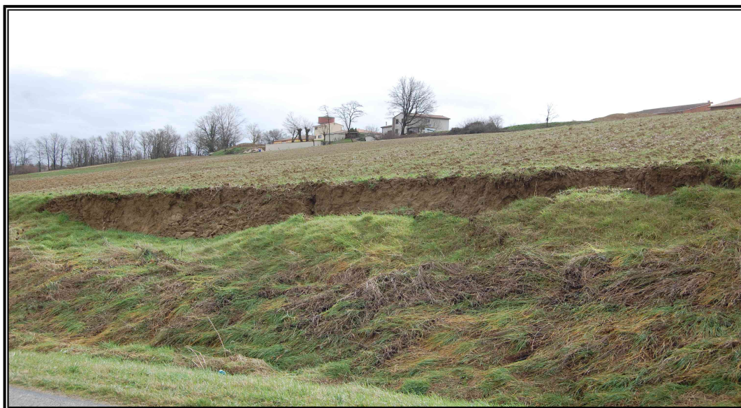
Photo 4 : Lieu-dit « Saint-Victor » commune de Lanta, photo prise le 5 février 2013. Glissement par foirage en paquets désorganisé sur un talus de route à pente moyenne.
