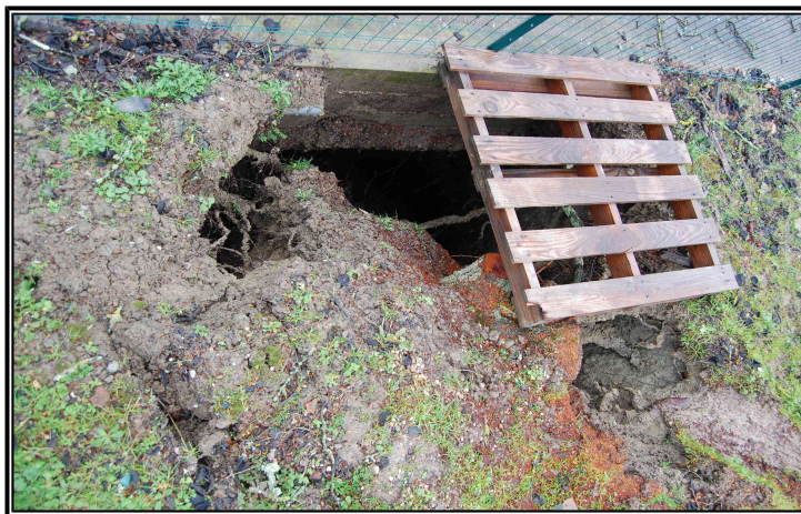
Photo 5 : Lieu-dit Sainte Quitterie commune de Mons, photo prise le 5 février 2013. Nous avons recensé l'effondrement brutal d'une cavité souterrain artificielle.
