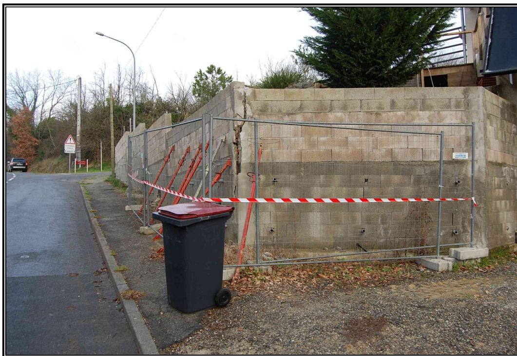
Photo 6 : Commune de Dremil-Lafage, Avenue des Millières. Le mur est peu efficace pour résister à une poussée de terres, lors de la saturation de l'ensemble des terrains (déblais-remblais). Le risque effondrement du mur est imminent.
