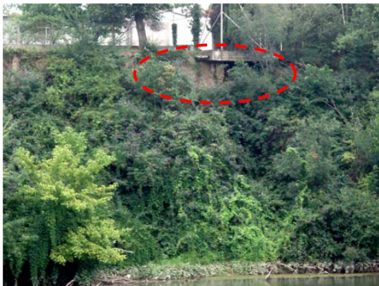
Instabilités récurrentes (aménagement en surplomb) Zone d'activité, secteur de Marclan
