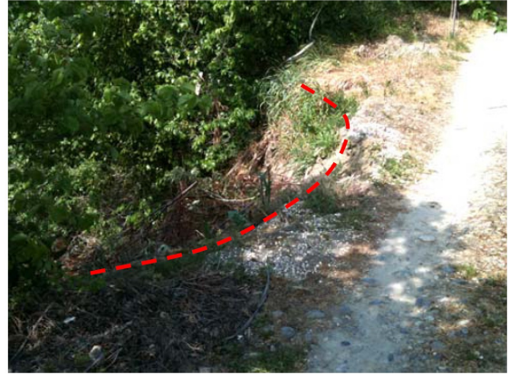
Arrachement superficiel (recul \approx 0,5 à 1 mètre) Lotissement de la rue Pierre Mendès France
