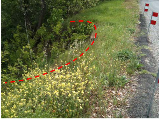
Cicatrice d'un ancien effondrement (recul \approx 2 mètres) Chemin de l'Hobit
