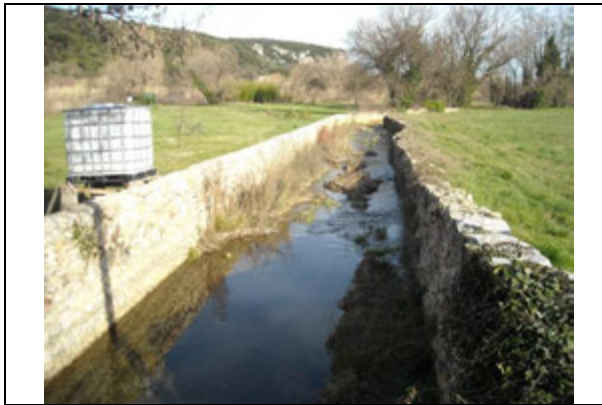
Photo 50 : Vue du mur de soutènement en aval du pont du chemin du Plan des Mômes (lit majeur du Gardon)
