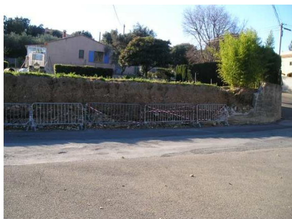
Photo 21 : Mur effondré rue des Pins la Cruvière
