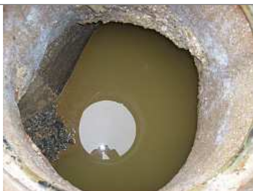
Photo 6 : Dépôt de sable et graviers – regard ARE005, place de la Poste
