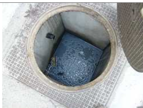
Photo 7 : Avaloir en charge – avenue des Troènes
