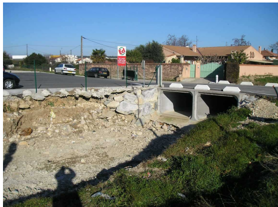
Photo 23 : La Pondre - Affouillements
