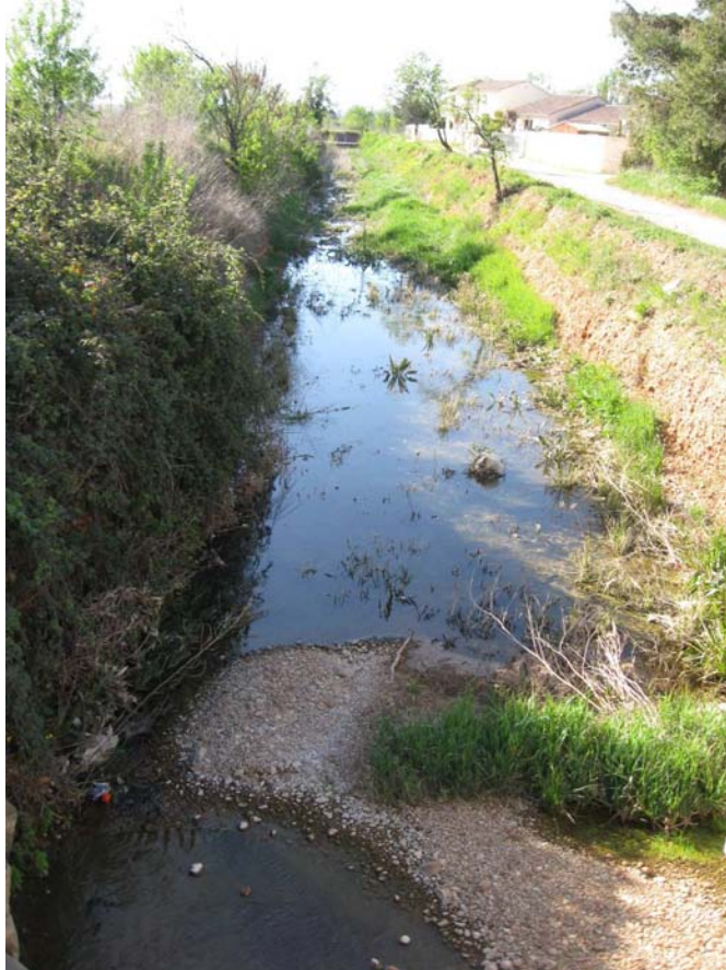
Photo 2 : sédimentation dans le lit mineur (exhaussement du fond)
