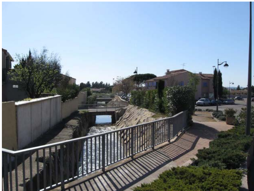
Photo 1 : ouvrage limitant pouvant favoriser les débordements en rive droite
