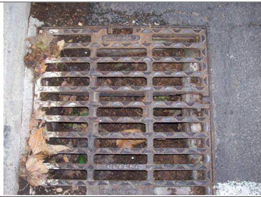
Photo 9 : Grilles bouchées de la rue de la Vaunage
