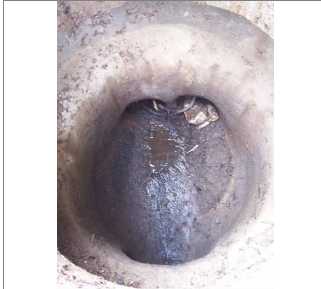
Photo 5 : Vue sur le doublement des conduites
