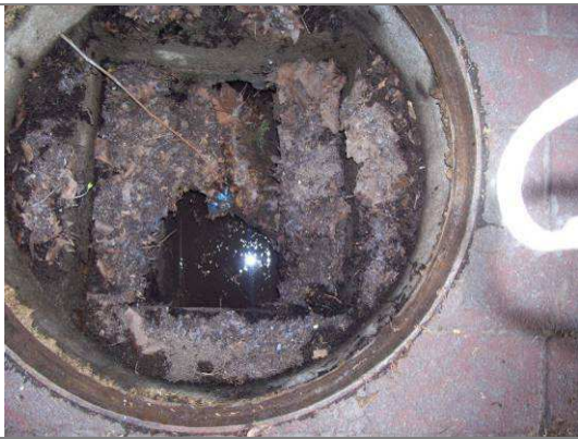
Photo 8 : Réseau de la rue de la Vaunage
