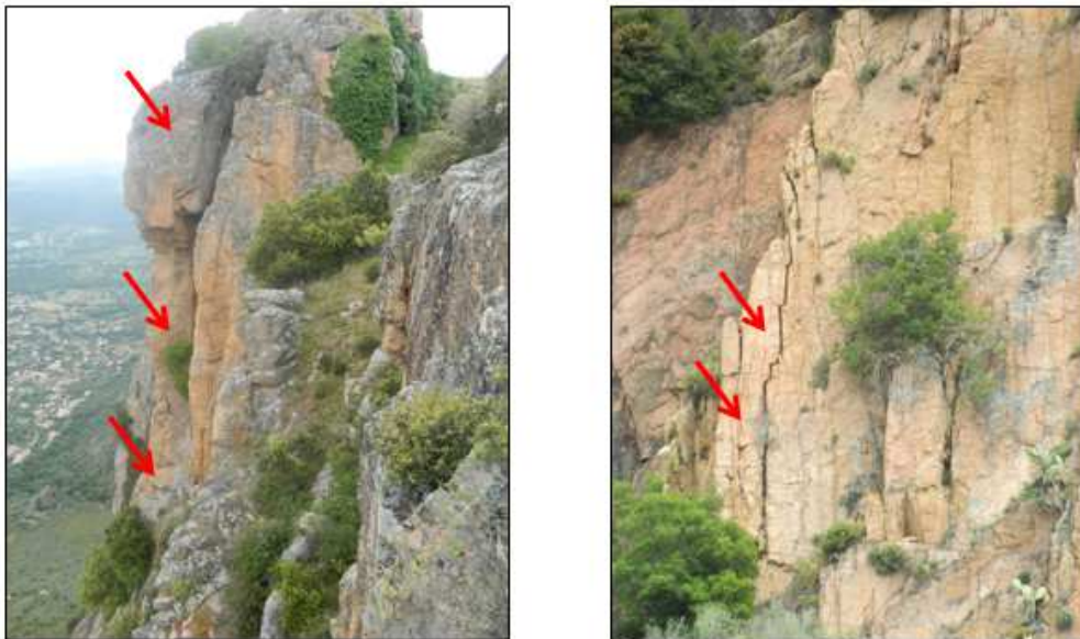
Figure 22: Exemples de rupture possible de colonnes en pied (à gauche partie sommitale du Rocher des Gozzi, à droite secteur de Piscia Rossa)
