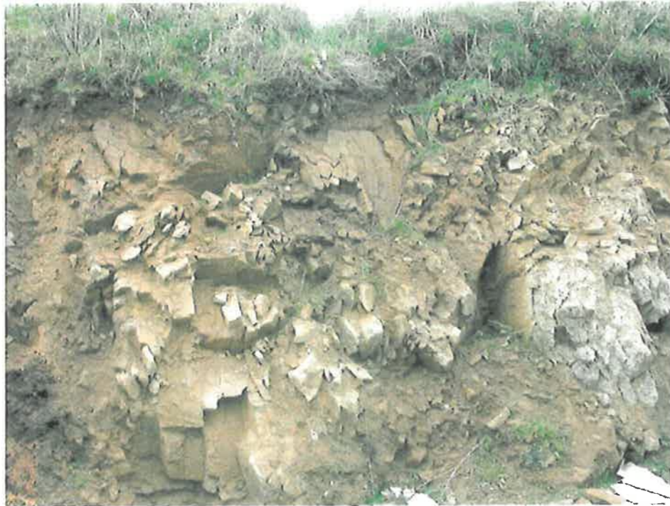
Illustration d'un aléa de chutes de pierres (P1) localisé derrière le magasin Casa à Tréboul
