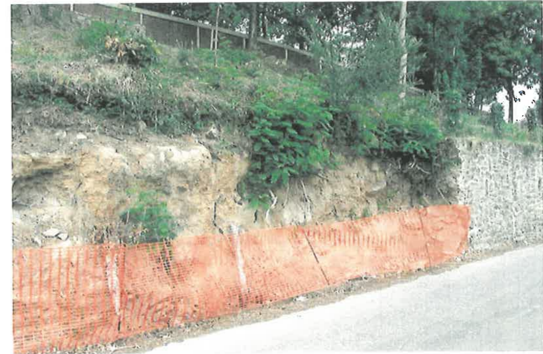
Exemples de désordres en milieu anthropique à Tréboul
