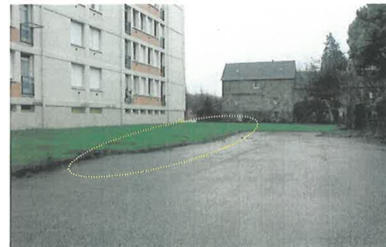
Exemple de désordres à Pouldavid : Déformation de la chaussée et des bordures
