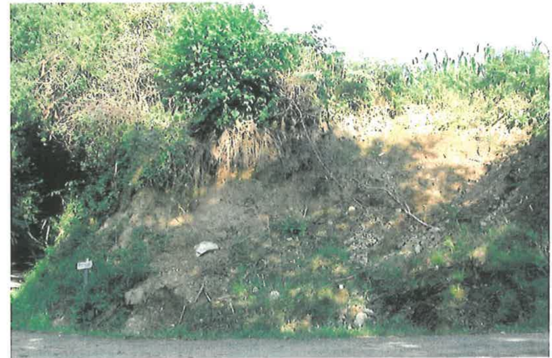
Exemple de glissement superficiel le long de la voie communale de Toul an Dreiz
