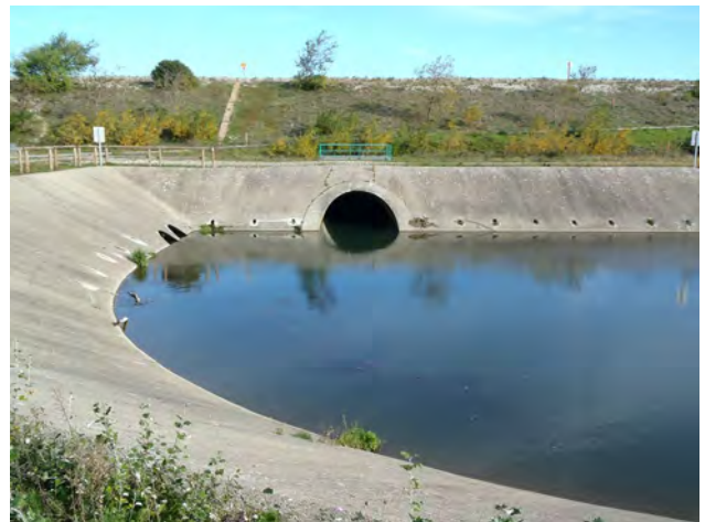
Sortie du siphon sous le canal CNR
