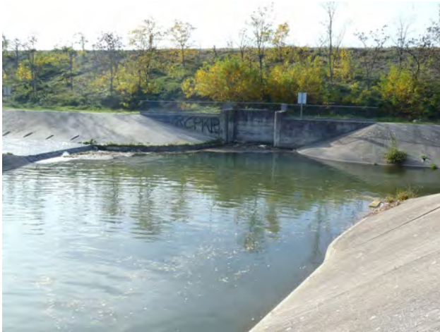
Siphon et arrivée des deux contre canaux
