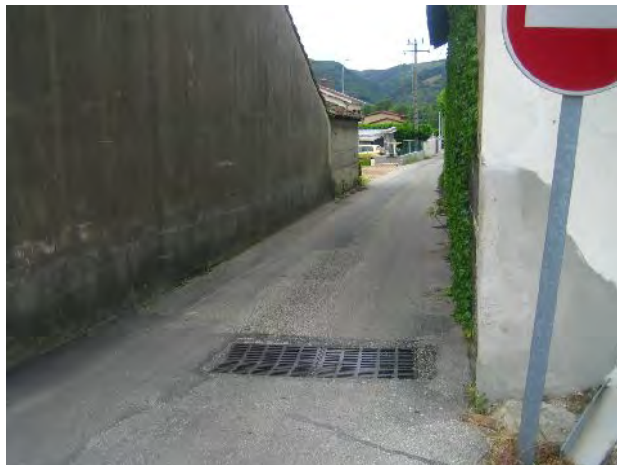
Tampon de regard dans la plaine, du ruisseau des Barres canalisé (source : DDT26)
