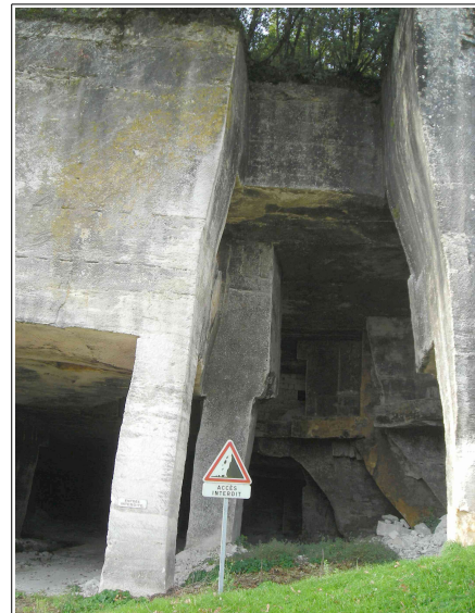
Entrée des Caves Noires, lieu de l'accident qui coûta la vie à 9 personnes en 1848. On remarquera la section réduite des piliers de l'entrée. En arrière plan, on distingue la faible épaisseur de certaines dalles de plancher intermédiaire. C'est probablement la rupture de l'une d'elle qui provoqua l'accident.
