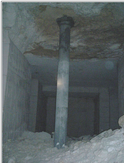
Vue du pilier sous une maison du quartier du Dorland. On notera l'aspect très dégradé du plafond
