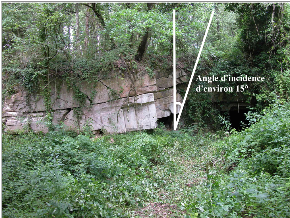
Cavité effondrée sur le site de la carrière 7, on distingue à la base de l'affleurement rocheux la bordure de la cavité et au sommet la masse rocheuse déplacée au-delà de l'emprise de la cavité.
